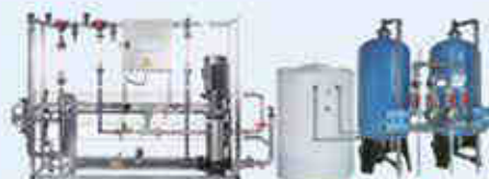
Εξοπλισμός επεξεργασίας νερού
